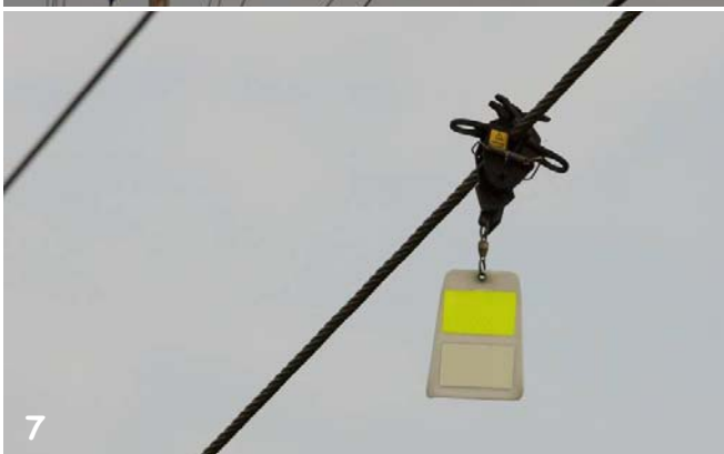
Foto 6 y 7: Aparato anticolisión colocado en línea de distribución en Seattle, EE. UU. Foto P. Valenzuela
