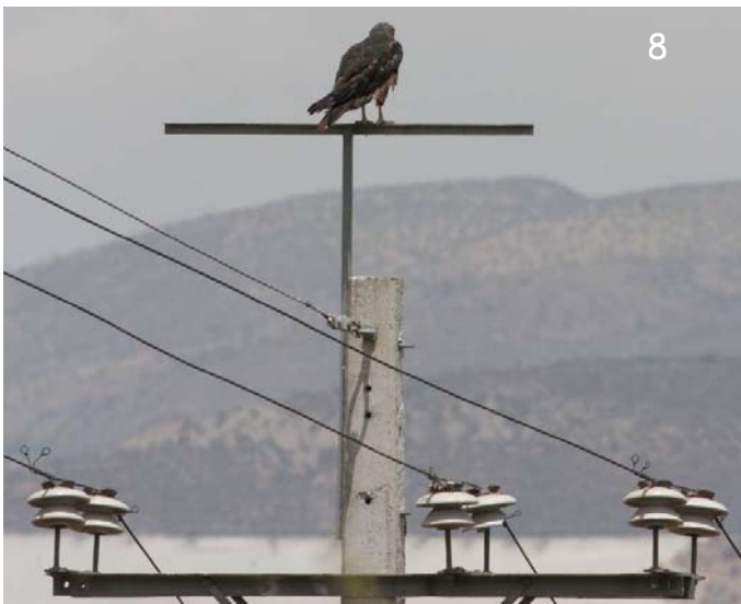
Águila juvenil ( Geranoaetus melanoleucus ) posada sobre mitigación colocada en la línea de distribución que abastece al tranque de relaves de Ovejería, Tiltil. Se observa bajo el ave la cruceta de metal y los aisladores rígidos, previo a la mitigación las aves se electrocutaban al posarse en la cruceta y tocar los conductores. Foto P. Valenzuela.
